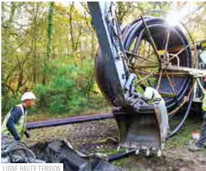
LIGNE HAUTE TENSION
