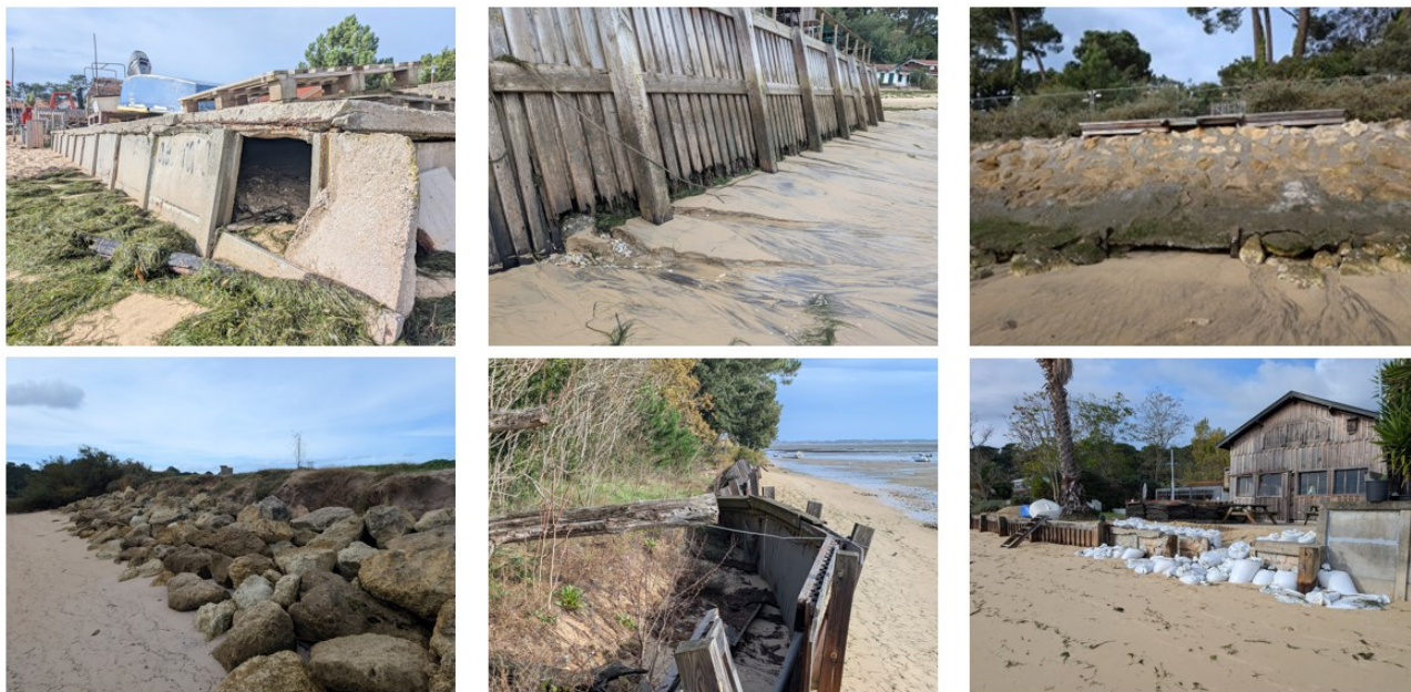
Figure 1-11 Exemples de désordres observés sur des ouvrages longitudinaux : zones de résurgence provoquant des affouillements en pied d'ouvrage, destruction partielle, dislocation, brèches, éboulements.
