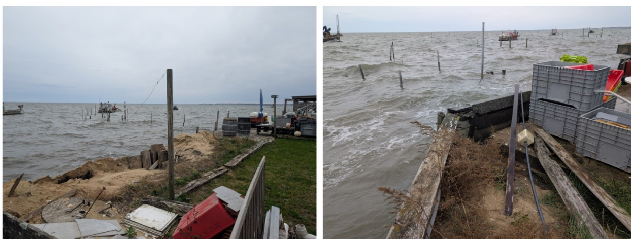
Figure 1-16 Exemple (1) d'attaque par les vagues et de surverse ponctuelle au droit d'un tronçon dégradé. Ces sollicitations répétées fragilisent l'ouvrage et peuvent réduire sa capacité à contenir l'érosion et la submersion.
